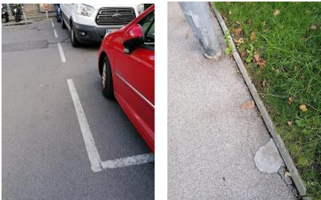
Die Tafel für den Behindertenparkplatz wurde entfernt (Foto rechts), die Begrenzungslinien sind noch da.
