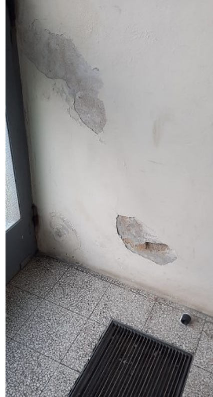
Vor der Reparatur - viele Löcher und der Verputz bröselst (Foto: privat)
