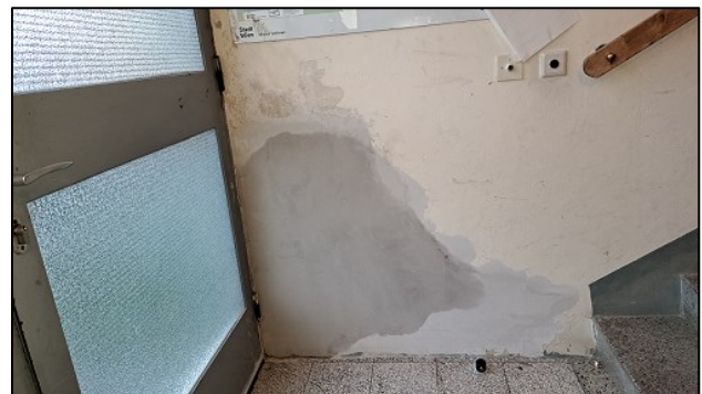
Schön ist es nicht, aber die Löcher wurden immerhin verputzt
