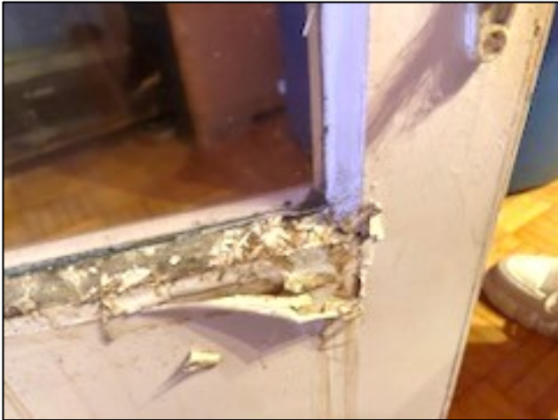
Viele Fenster im Gemeindebau müssten getauscht werden (Foto: privat)
