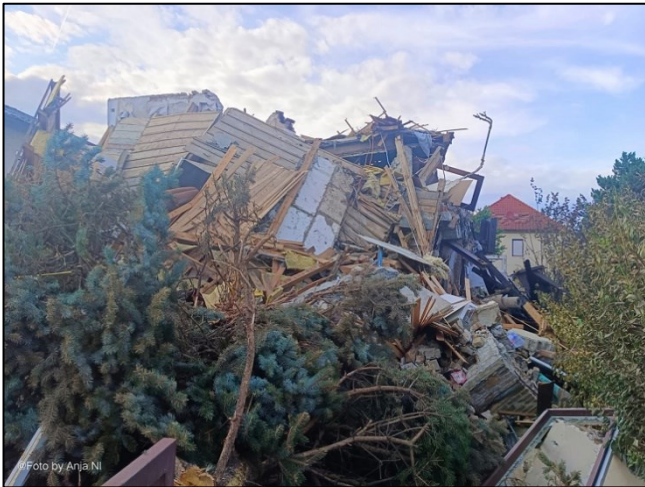
Das Einfamilienhaus wurde durch die Explosion komplett zerstört (Foto: Anja NI)
