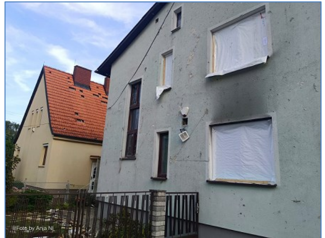
Auch Fenster von benachbarten Häusern bzw. deren Dächer wurden beschädigt (Foto: Anja NI)
